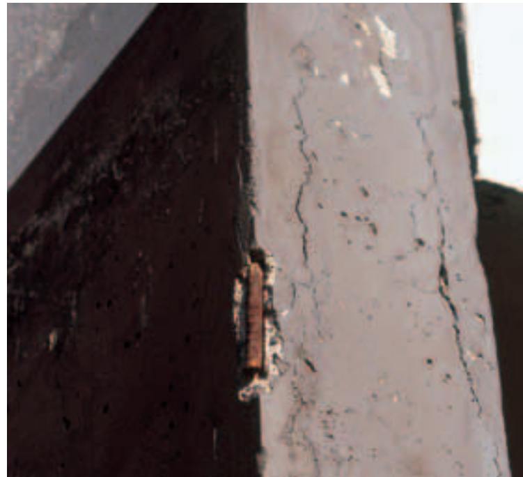
Процесс ржавления металлической арматуры в бетоне приводит к его растрескиванию
